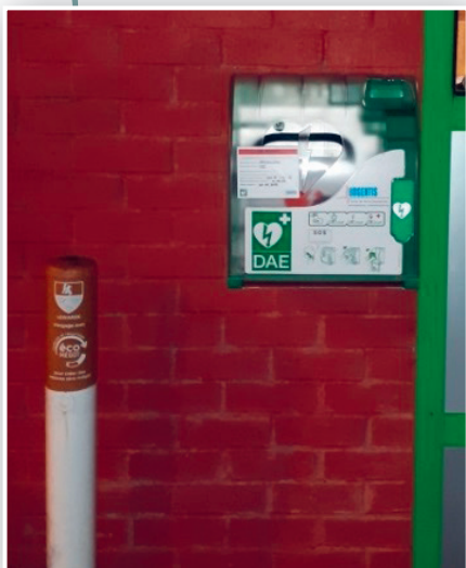
Installation de défibrillateurs
