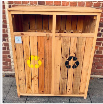
Installation de poubelles d'amélioration du tri aux écoles
